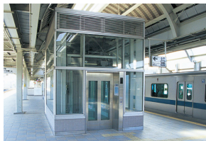
エレベーター
