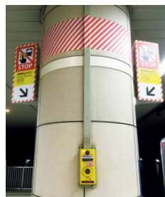
非常停止ボタン
