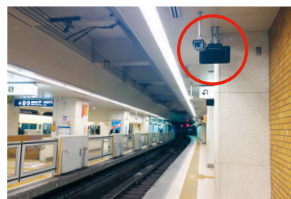
ホーム注意喚起システム
