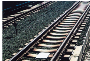
ロングレール(弾性マクラギ砕石軌道)
