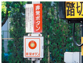
踏切支障報知装置
