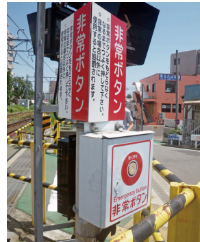
踏切非常ボタン
