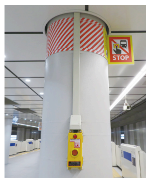
非常停止ボタン
