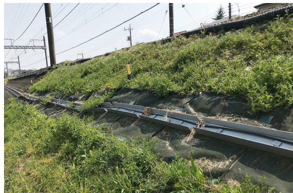
土砂崩壊検知システム
