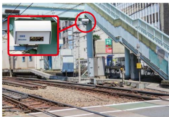
踏切障害物検知装置（イメージ）
