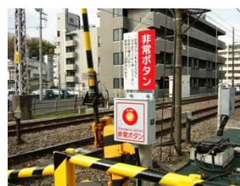
踏切に増設する非常ボタン
