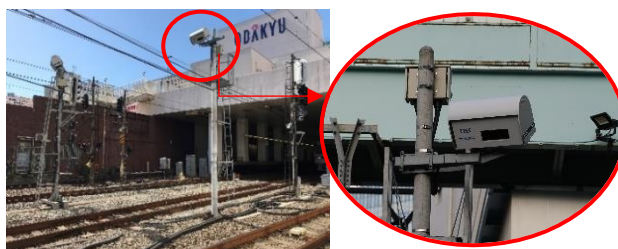
踏切障害物検知装置 レーザーレーダ方式
