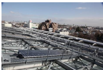
経堂コルティに設置している 太陽光発電システム
