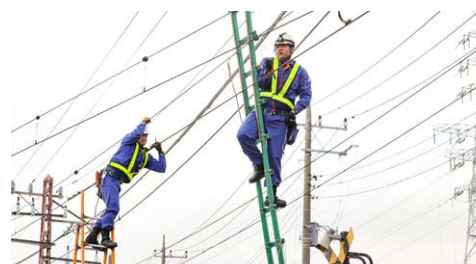
設備復旧訓練（電気部）
